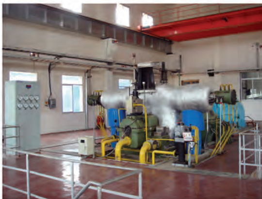
湖南印山台水泥有限公司10MW纯余热发电站 10MW WHRS Plant at Hunan Yinshantai Cement Co.,Ltd.
